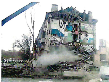
Рис. 8. Обрушение торцевой секции жилого дома
